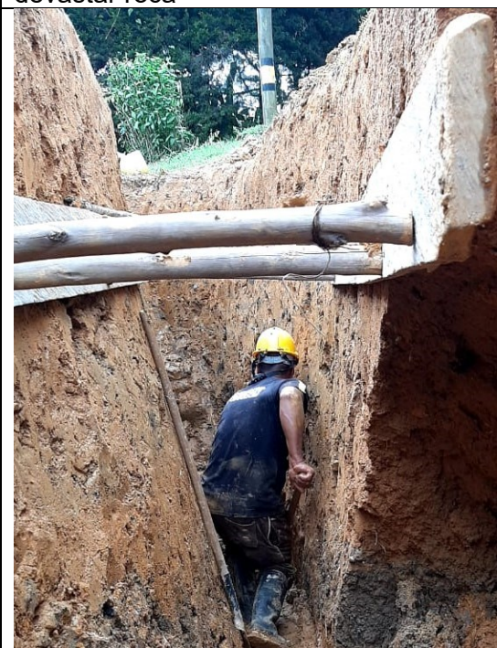
Foto 5: Entibado en tramo donde se presentaron derrumbes
