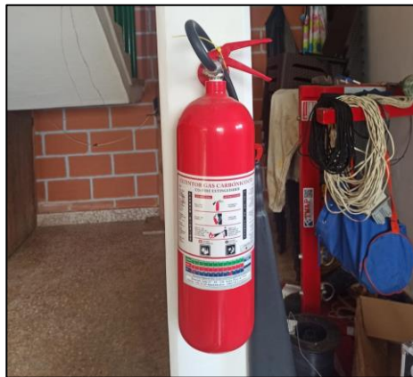
Fig 51. Extintor de la PTAP.
