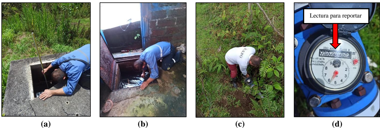
Fig 33. Actividades de operación en los tanques de almacenamiento.
