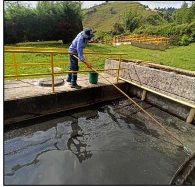
Fig 33. Limpieza del sobrenadante en el digestor de lodos.
