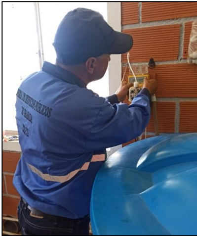
Fig 22. Graduación de la bomba con el caudal de dosificación.
