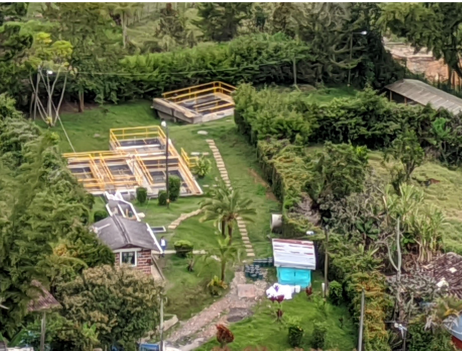
Lugar: Planta de Tratamiento de Aguas Residuales domésticas (PTAR) del municipio de Granada. ©Fotografía: Santiago Londoño Vélez.
