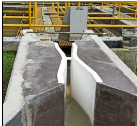
Fig 16. Canaleta Parshall de 3''.
